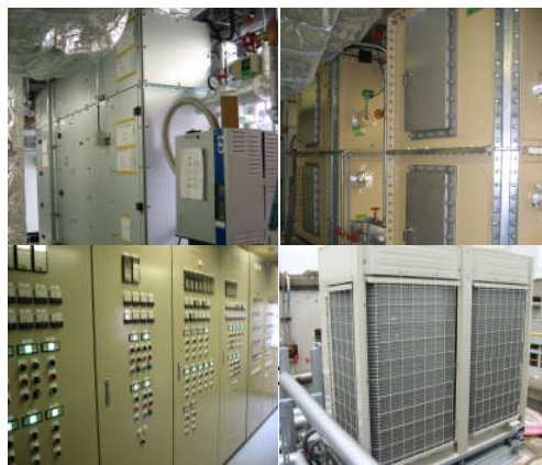
空調用制御盤(左)と室外機(右)
